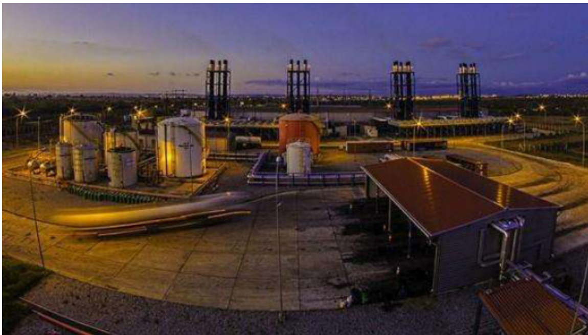
Figura 5 – Usina termelétrica de Campina Grande. (Fonte: Repositório da Borborema Energética)
