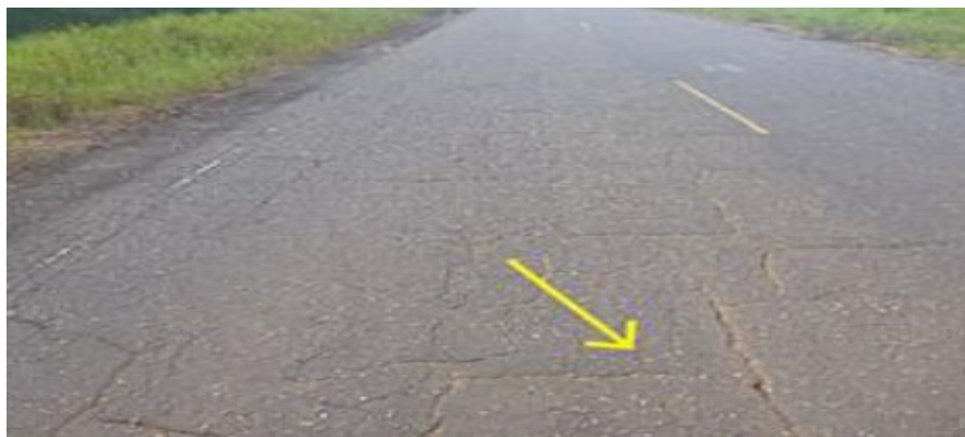
Figura 12 – Trincas tipo “blocos” Fonte: DNIT (2003)
