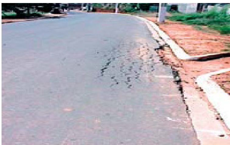
Figura 14 – Afundamento por consolidação Fonte: Bernucci et al. (2008, p. 419)
