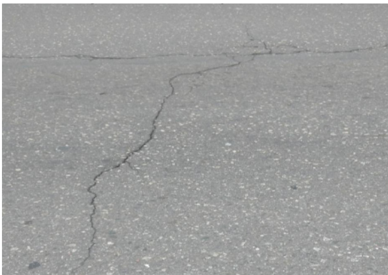
Figura 10 – Trinca isolada de retração Fonte: Chicoski et al. (2017, p. 19)
