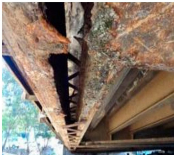
FIGURA 1 – Corrosão generalizada com perda de seção Fonte: Dias (1997, p. 14)
