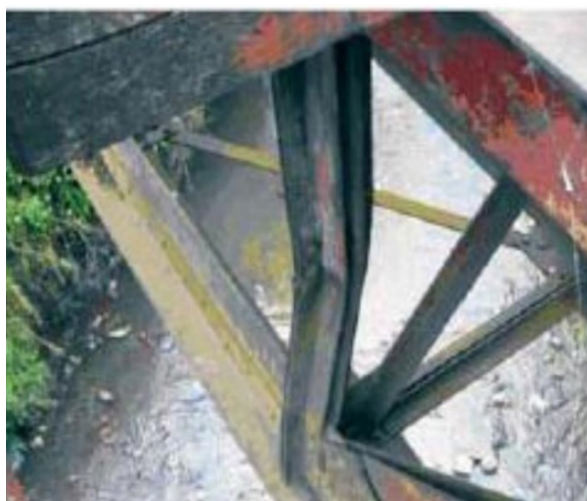
Figura 3 - Montante com flambagem global Fonte: Cardoso (2007).
