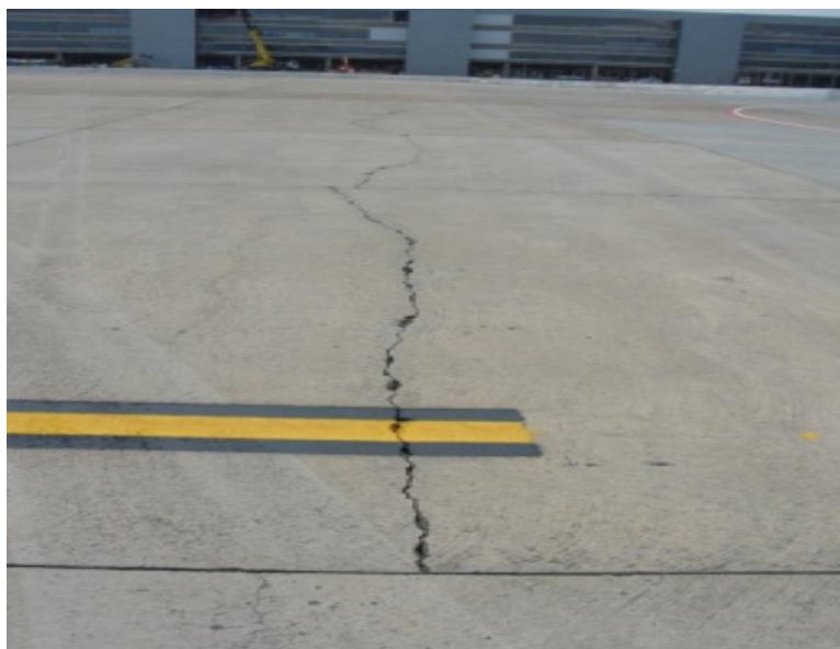
Figura 7 – Fissura transversal Fonte: Pedro Vitória (2016)
