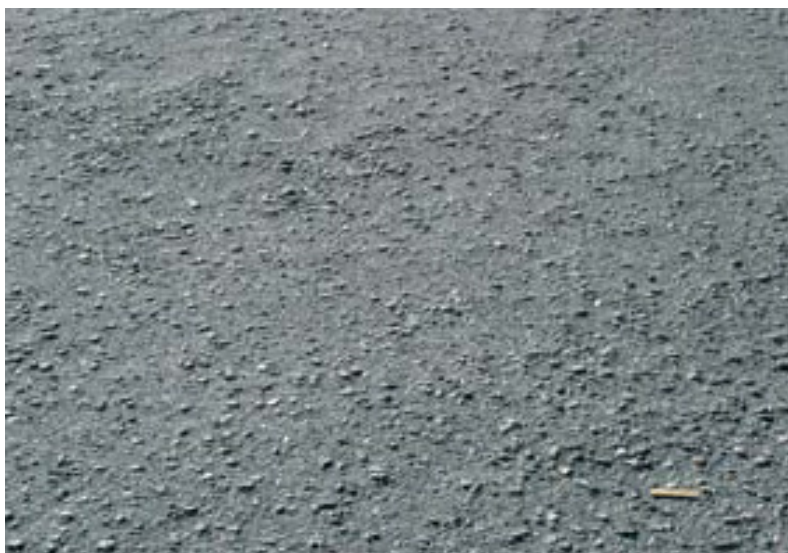
Figura 18 – Desgaste ou desagregação Fonte: Bernucci et al. (2008, p. 421)
