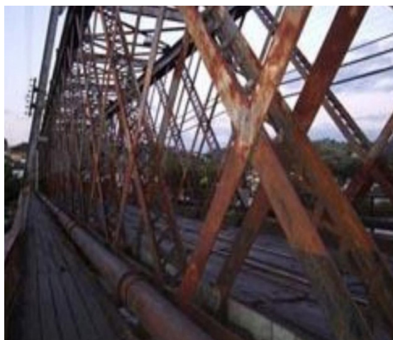
Figura 5 - Corrosão na estrutura da ponte de aço. Fonte: Cardoso (2007).
