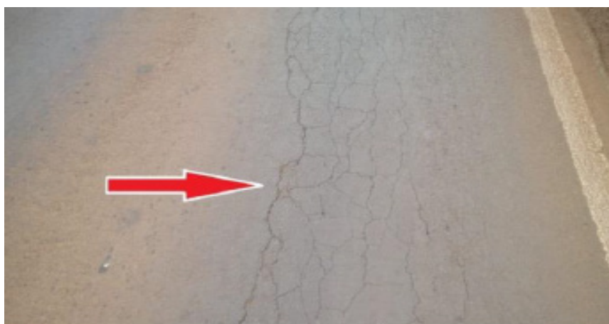
Figura 11 – Trincas tipo “couro de jacaré” Fonte: Silva (2018, p. 14)
