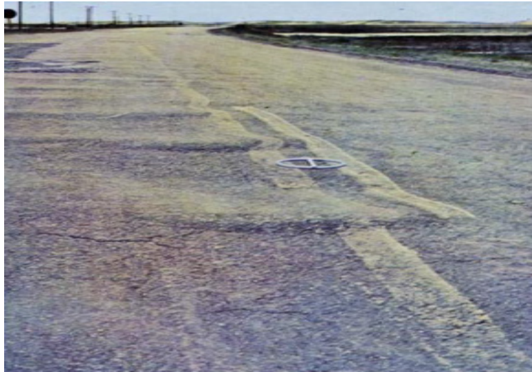
Figura 15 – Ondulação ou Corrugação Fonte: DNIT 005 – TER (2003)
