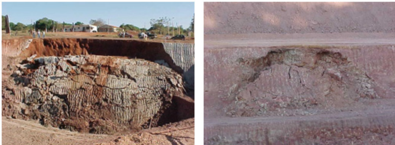
Figura 5 – Deslizamento entre as estacas km 216 + 024 a 216 +060 LD
