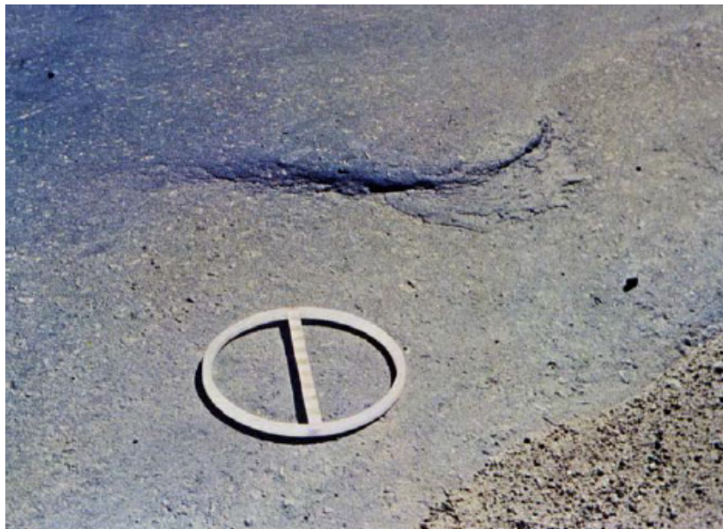
Figura 16 – Escorregamento Fonte: DNIT (2016)
