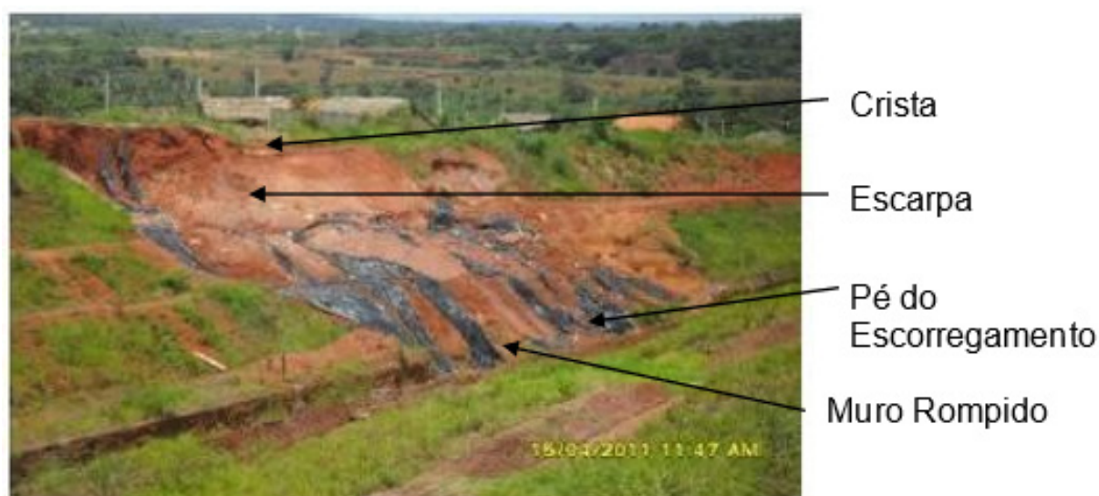
Figura 6 – Deslizamento entre as estacas km 216 + 024 a 216 +060 LD
