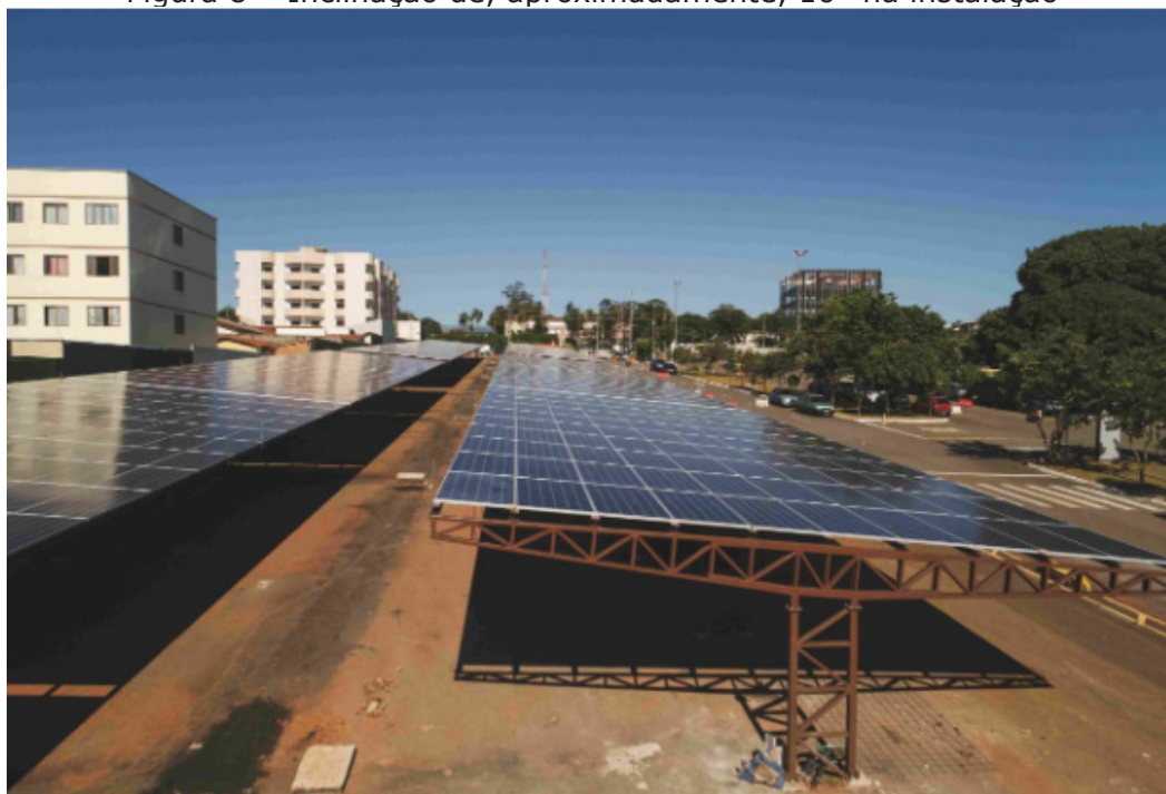
Figura 8 – Inclinação de, aproximadamente, 10° na instalação
