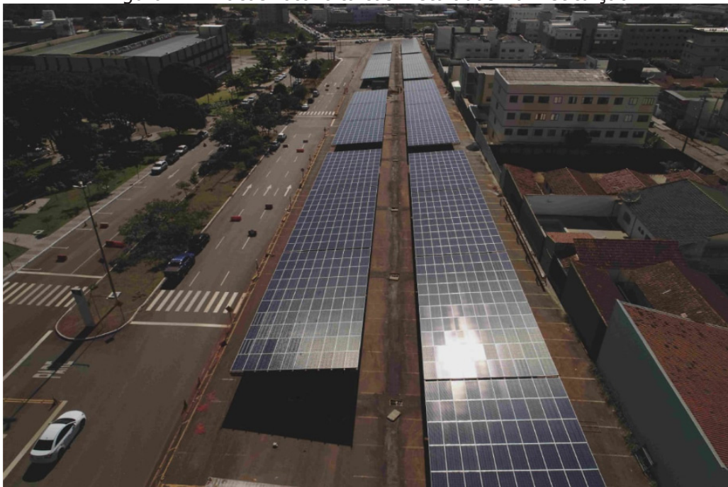
Figura 7 – Placas fotovoltaicas instaladas na instituição
